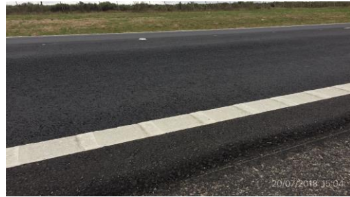
Ilustración 5 – Detalle de mantenimiento por niveles de servicio: sellado de fisuras, demarcación horizontal
