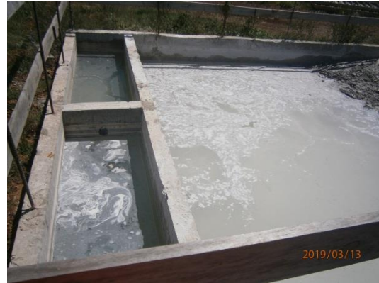
Ilustración 12 – Obrador Principal Pileta de lavado de camiones
