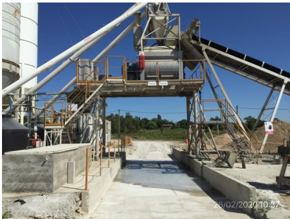
Ilustración 6 – P03, Planta de hormigón, zona de carga de mixers
