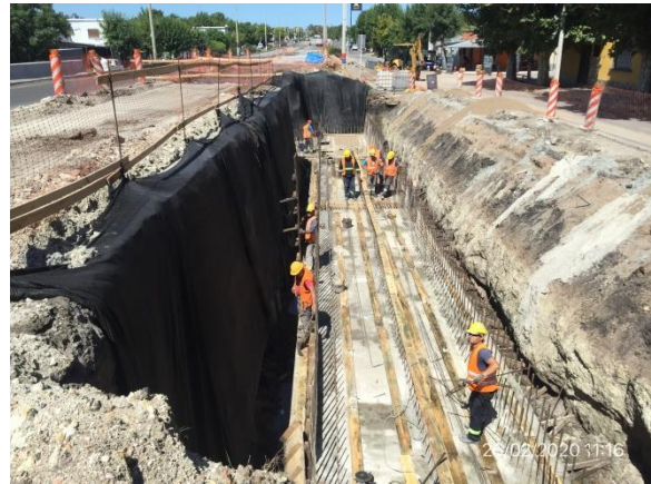
Ilustración 17 – Tramo de obras en Ruta 5 en planta urbana de Durazno, pasaje peatonal subterráneo
