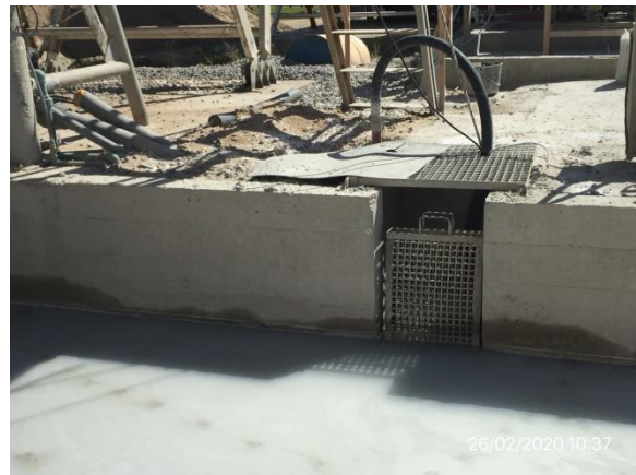
Ilustración 7 – P03, Planta de hormigón, desagüe de zona de carga hacia planta de recirculación
