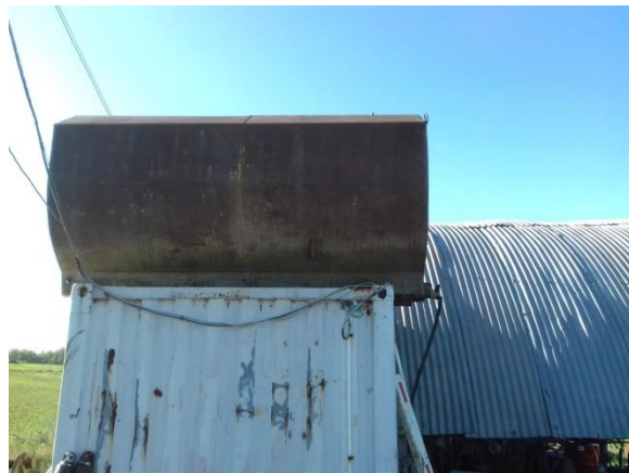
Ilustración 13 – Tanque elevado para acopio de agua no potable alimentado desde camiones cisterna
