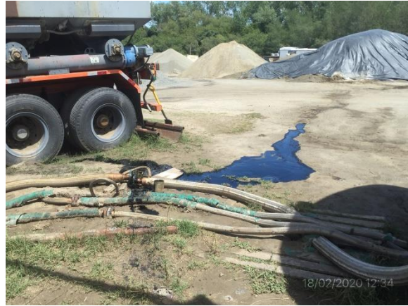
Ilustración 11 – Obrador. Derrame de emulsión C30
