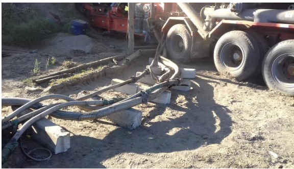
Ilustración 12 – Obrador. Derrame remediado según plan de contingencias – ilustración provista por la empresa el 20/02/2018
