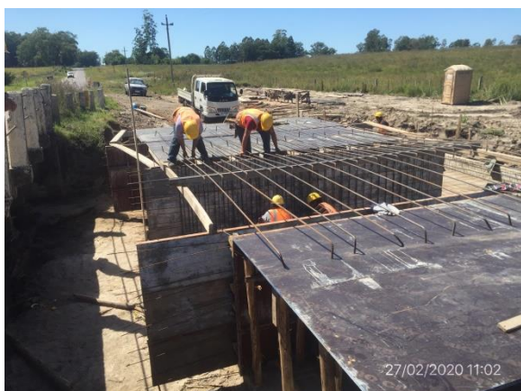
Ilustración 8 – Alcantarilla en obra - P03, carente de infraestructura adecuada para acopio y gestión de residuos sólidos
