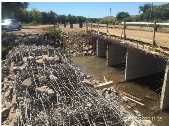
Ilustración 14 – Alcantarilla en obra y Obrador, P01. Demolición de alcantarilla existente, carente de infraestructura adecuada para acopio y gestión de residuos sólidos
