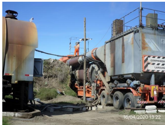
Ilustración 11 – Obrador. Conexiones flexibles entre tanques de emulsión y planta asfáltica sobre suelo compactado sin envallar.
