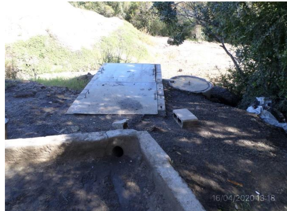
Ilustración 5 – Obrador. Trampa de grasas para aguas de lavado
