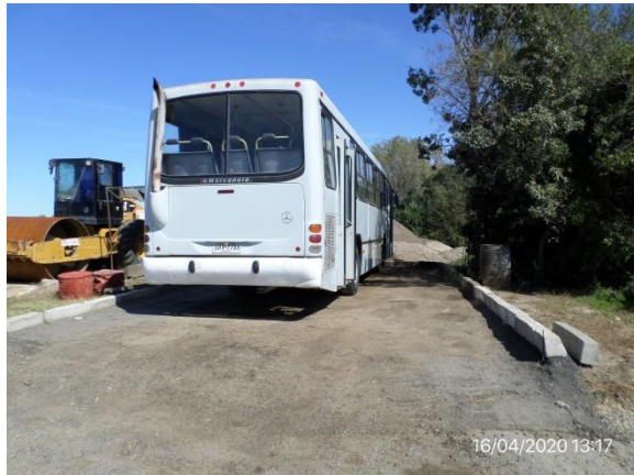
Ilustración 4 – Obrador. Zona de lavado con suelo compactado y dique perimetral
