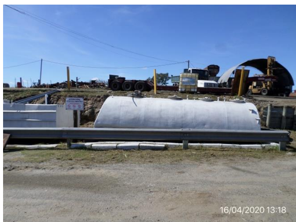
Ilustración 6 – Obrador. Tanque de combustible con envallado perimetral
