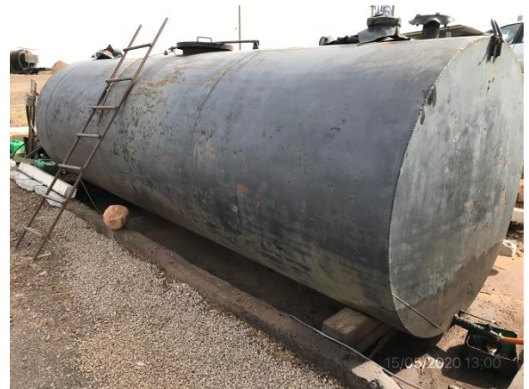
Ilustración 13 – P07. Obrador. Tanque de combustible envallado
