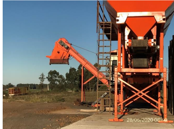
Ilustración 17 – P03. Obrador, planta asfáltica con filtro de mangas
