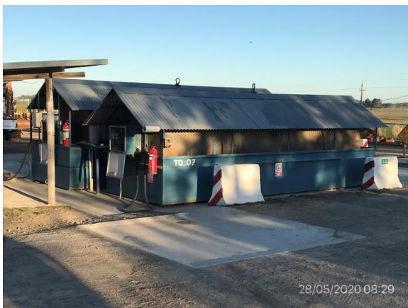
Ilustración 8 – P03. Obrador. Depósitos de combustible con envallado y techo.
