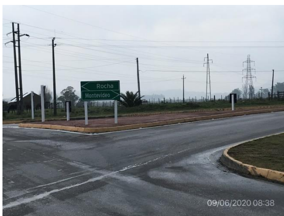
Ilustración 8 – P02, fin de tramo de obras de Ruta 9 en Pan de Azúcar. Rotonda con calle Rincón terminada
