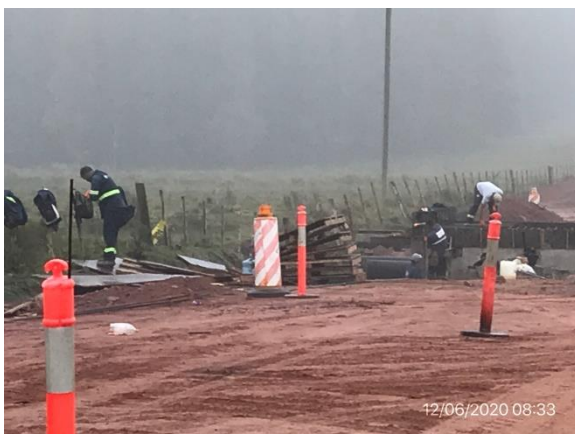
Ilustración 8 – P03, nueva alcantarilla en construcción, Cno. de la Balsa sobre Cda. de Doña Ana.
