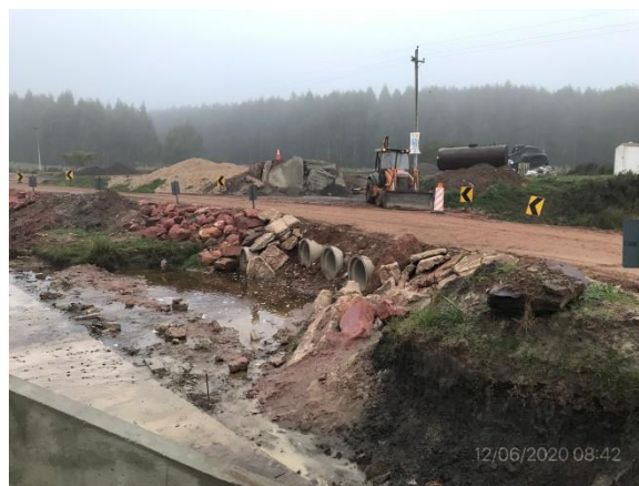
Ilustración 11 – P04, nueva alcantarilla en construcción, Cno. de la Balsa sobre Cda. de La Tranquera.
