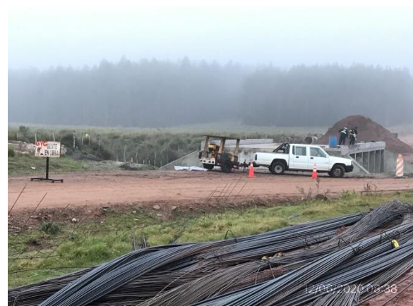
Ilustración 9 – P04, nueva alcantarilla en construcción, Cno. de la Balsa sobre Cda. de La Tranquera
