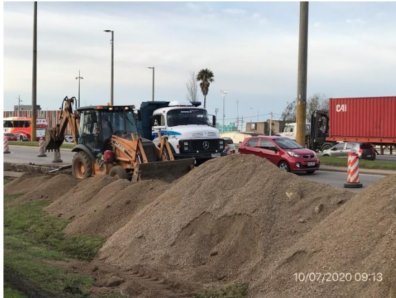
Ilustración 10 – P04 - Frente de obras: reparación de cordones y cantero central en intercambiador Rutas 1 y 5 con Av. Santín Carlos Rossi.
