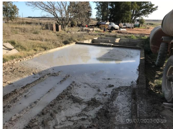
Ilustración 13 – P03, obrador. Planta de lavado de camiones míxer con zona de decantación y recirculación de agua
