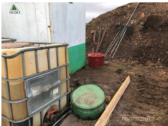
Ilustración 6 – P04 , Cantera de tosca y basalto, padrón rural N°1.888, 5ª SC de Paysandú, pañol y zona de trasiego de combustible
