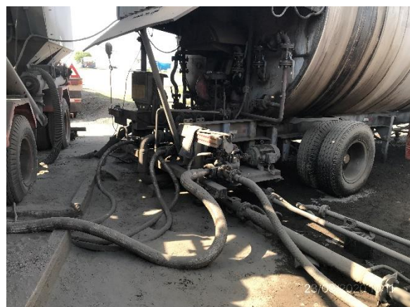
Ilustración 21 – P03. Planta asfáltica. Tuberías de hidrocarburos en sector envallado
