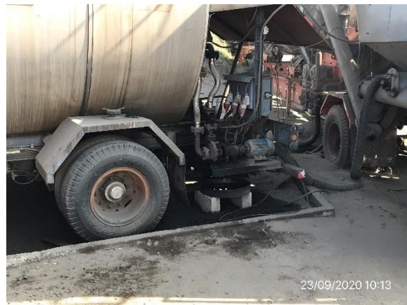
Ilustración 19 – P03, Planta asfáltica. Depósito de emulsión asfáltica con pavimento impermeable y envallado perimetral.
