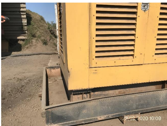
Ilustración 20 – P03. Planta asfáltica. Generador eléctrico en recinto metálico
