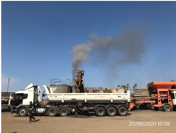
Ilustración 10 – P03 Planta Asfáltica. Emisiones abundantes de humos por falta de filtros en chimenea
