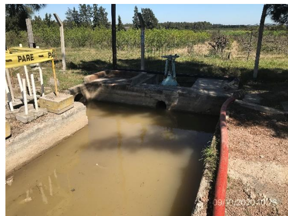
Ilustración 15 – P03. Obrador. Planta de decantación de aguas de lavado.
