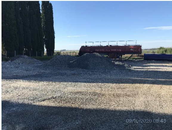
Ilustración 10 – P03, obrador. Depósitos fijos de emulsión asfáltica con envallado perimetral y superficie inferior impermeabilizada
