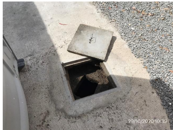
Ilustración 19 - P03, Obrador secundario. Depósito impermeable de efluentes
