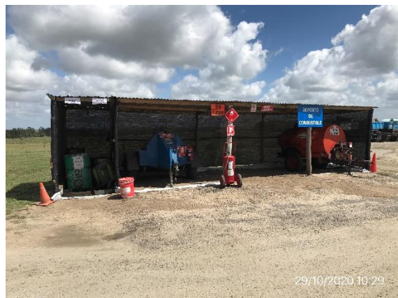
Ilustración 9 – P03, Obrador secundario. Depósito de combustible en silo envallado y techado
