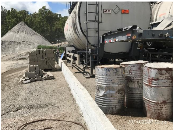
Ilustración 14 - P03, Obrador secundario Planta asfáltica con zona de traspiego de emulsiones asfálticas envallada
