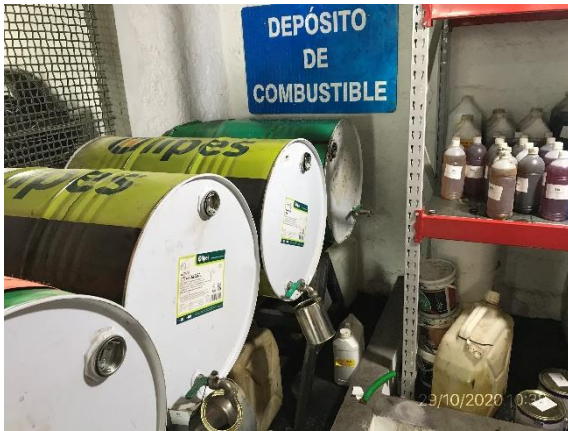
Ilustración 16 - P03, Obrador secundario. Depósito de combustibles en recinto cerrado
