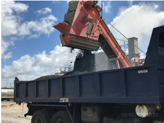
Ilustración 12 – P03, Obrador secundario. Planta asfáltica con filtro de mangas
