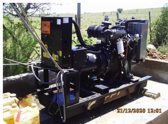
Ilustración 9 – P04, obrador secundario. Generador de energía colocado correctamente sobre bandeja antiderrames.
