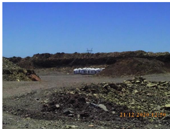
Ilustración 13 – P05, cantera de tosca y piedra. Portland en contenedores cerrados y sobre pallets en cantera.
