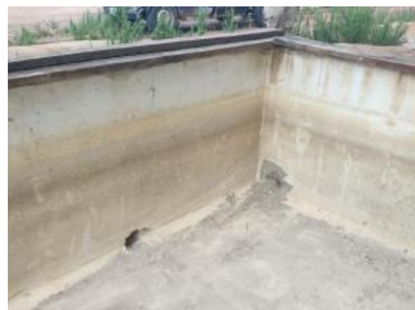
Ilustración 9 – P03, evidencia de pileta de curado de probetas con desagüe al fondo.
