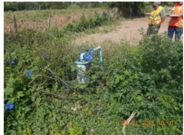
Ilustración 13 – P03, pozo semi surgente de agua.
