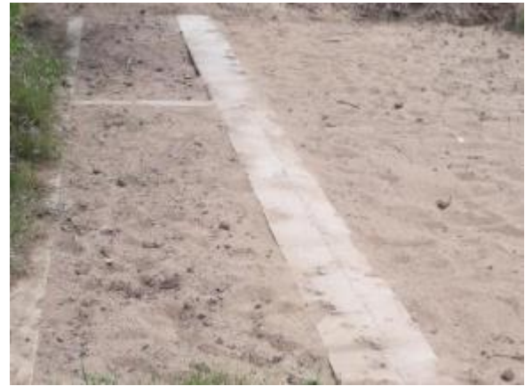
Ilustración 11 – P03, evidencia de pileta de lavado de hormigones rellena de arena.
