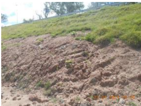
Ilustración 14 – Taludes de obra con indicios de asentamiento vegetal.
