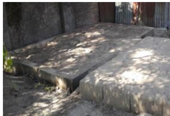
Ilustración 7 – P03, evidencia de relleno de arena en contención en zona de productos químicos.
