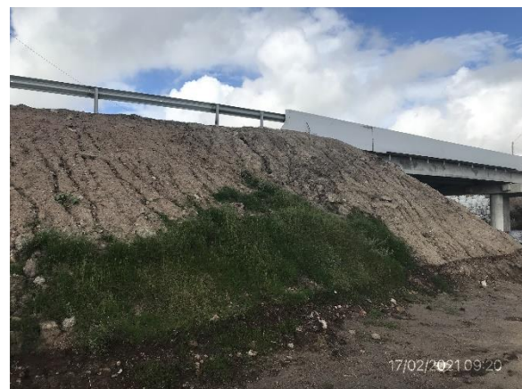
Ilustración 9 – P01, Taludes erosionados en acceso al puente.
