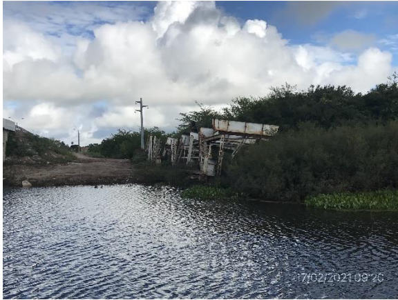
Ilustración 10 – P01, antiguo puente metálico desmembrado pero sin desmantelamiento definitivo.
