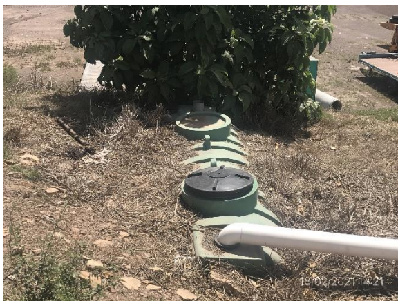
Ilustración 14 – P03, Obrador. Fosa séptica.
