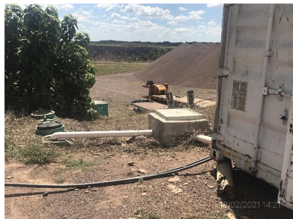
Ilustración 15 – P03, Obrador. Conexiones a fosa séptica.
