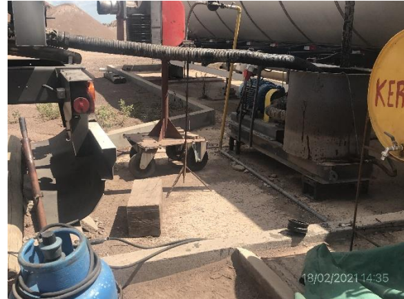
Ilustración 23 – P03, Planta asfáltica. Depósitos de emulsiones y caldera con envallado perimetral.
