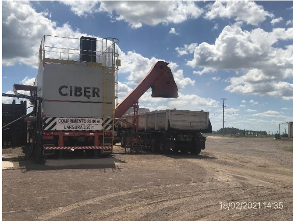
Ilustración 22 – P03, Planta asfáltica con filtro de mangas.
