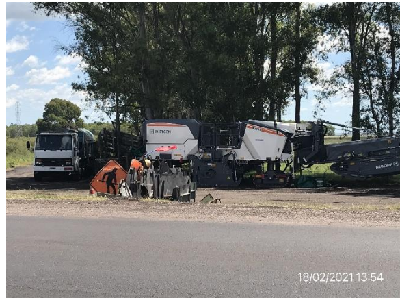
Ilustración 11 – P04, Campamento Provisionario. Ruta 5 progresiva 272K000 a (-). No hay infraestructura para gestión de residuos.
