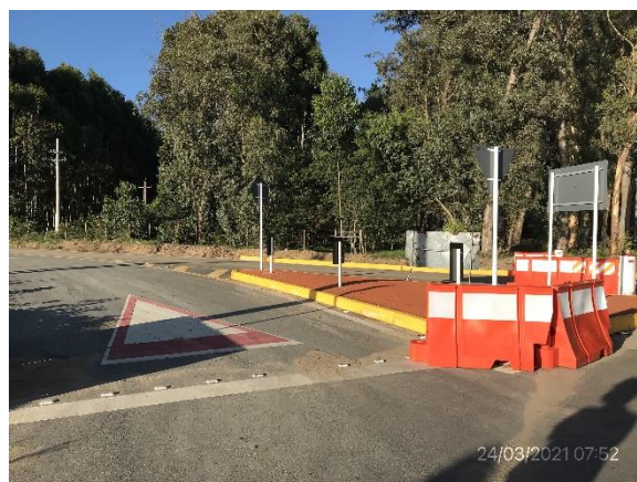
Ilustración 7 – Tramo de obras culminado, desvío de tránsito pesado al puerto de La Paloma.
