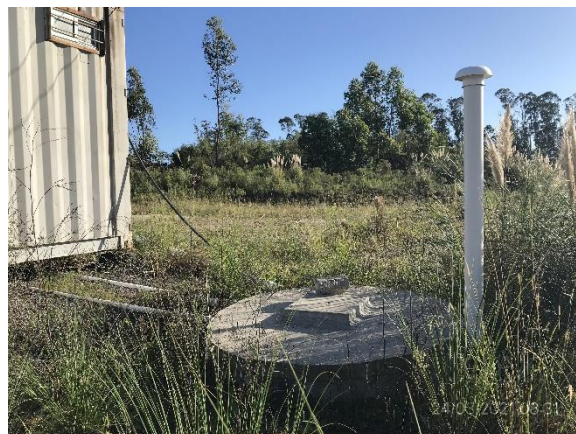
Ilustración 19 – P03, Obrador. Fosa séptica.
