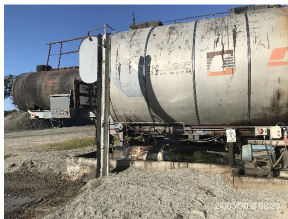
Ilustración 15 – P03, Planta asfáltica con contención perimetral en zona de depósitos de emulsiones
