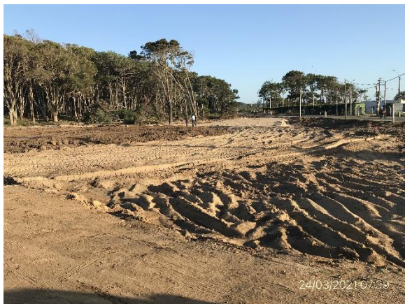
Ilustración 4 – P01, Inicio de tramo de obras, desvío de tránsito pesado al puerto de La Paloma. Nueva rotonda en construcción.
