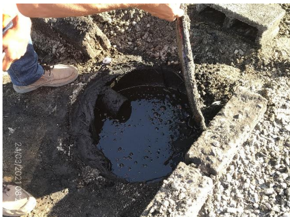
Ilustración 18 – P03, Obrador. Depósito de residuos líquidos en lavadero de camiones, sin trampa de grasas.
