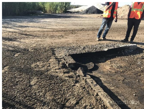
Ilustración 17 – P03, Obrador. Zona de lavado de camiones con contención perforada.
