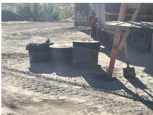
Ilustración 20 – P03, Obrador. Depósitos de residuos sin cartelería ni indicaciones por color.
