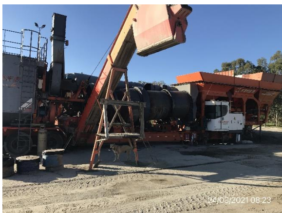
Ilustración 14 – P03, Planta asfáltica con filtro de mangas
