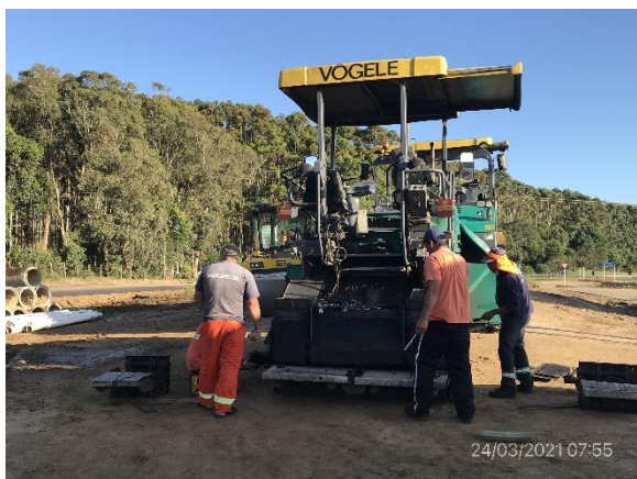
Ilustración 10 – P02, campamento provisorio. Mantenimiento de maquinaria vial en condiciones inadecuadas de prevención de derrames.
