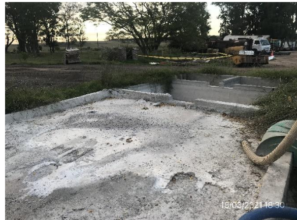
Ilustración 19 – P06, Obrador. Lavadero de camiones mixer con sistema de decantación de agua.
