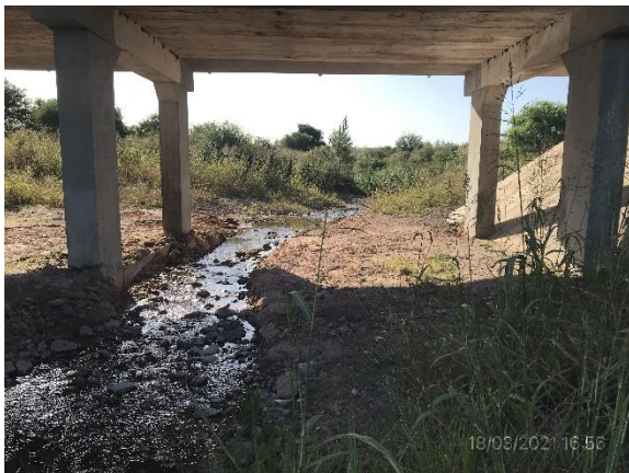
Ilustración 6 – P01, Obra terminada en puente sobre A° Caraguatá (76K750). Terraplenes constructivos sin desmontar, generan estrechamiento del cauce del arroyo.
