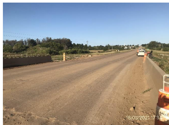
Ilustración 15 – P05, Obra terminada en puente sobre C da del Sauce (87K810), losa superior.
