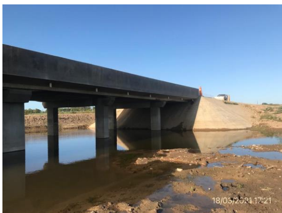
Ilustración 14 – P04, Obra terminada en puente sobre A° Juncal (85K110), vista del cauce con correcta recuperación ambiental.
