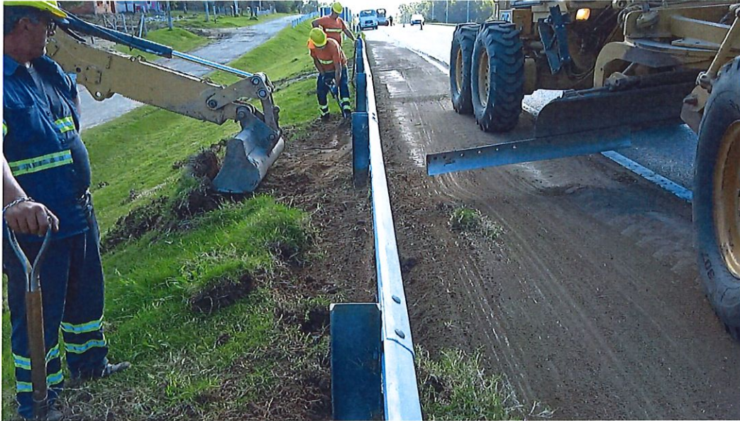
LIMPIEZA BAJO FLEX BEAM
