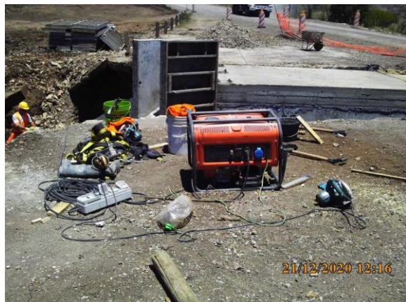
Ilustración 10 – Generador sin bandeja antiderrames en frente de obra.
