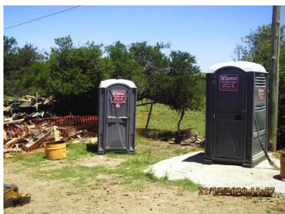
Ilustración 8 – P04, obrador secundario. Baños químicos.
