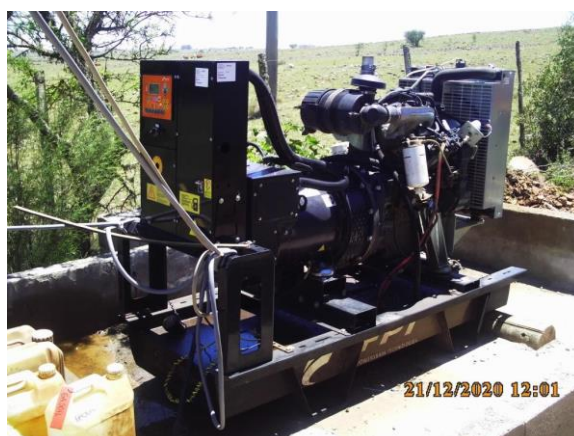
Ilustración 9 – P04, obrador secundario. Generador de energía colocado correctamente sobre bandeja antiderrames.
