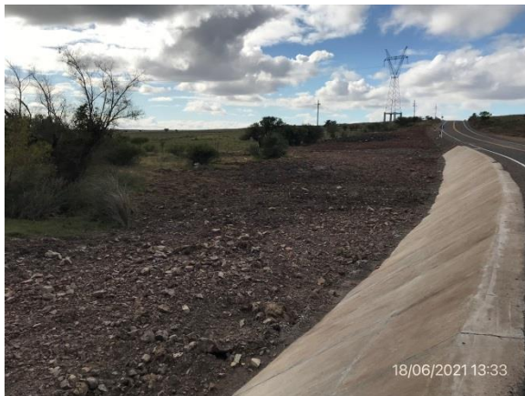
Ilustración 10 – P04. Obrador secundario desmantelado. Faja pública de Camino El Tala, progresiva 10K600 a (-). Puente y alcantarilla sobre A° El Tala.
