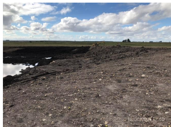
Ilustración 13 – P05. Cantera de tosca y piedra, taludes suavizados. Camino El Tala, progresiva 8K600 a (-).
