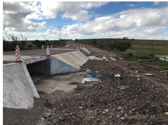
Ilustración 7 – P04. Alcantarilla terminada sobre ramal secundario de A° Tala, cauce limpio sin restos de obra. Cno. El Tala progresiva 10K600
