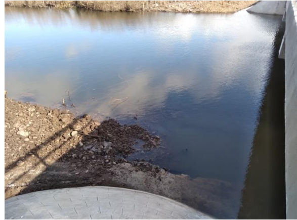
Ilustración 23 – P04. Puente terminado sobre ramal principal de A° Tala. Fueron removidos los escombros del lecho del cauce. Foto proporcionada por la empresa el 21/07/2021.
