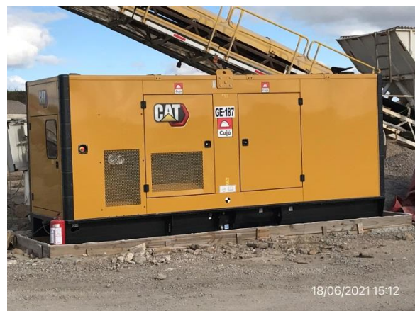
Ilustración 19 – P03. Obrero principal. Grupo electrógeno con envallado perimetral.
