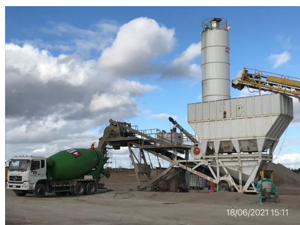
Ilustración 15 – P03. Obrador principal. Planta de hormigón, camión mixer en proceso de carga.
