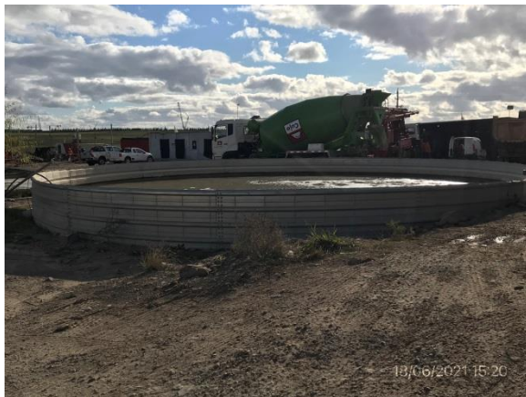
Ilustración 16 – P03. Obrero principal. Planta de hormigón, tanque australiano
