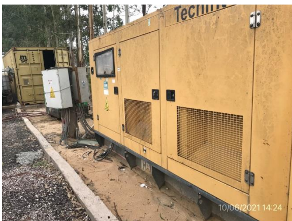
Ilustración 14 – P04, Obrador. Generador eléctrico.
