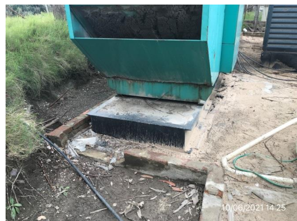
Ilustración 15 – P04, Obrador. Envallado perimetral de generador eléctrico perforado.
