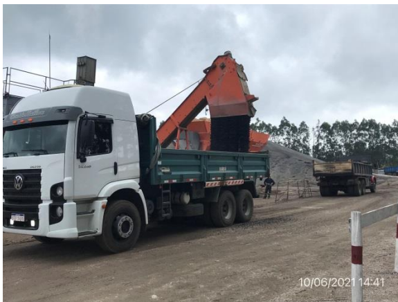
Ilustración 12 – P04, Planta asfáltica en operación de carga.
