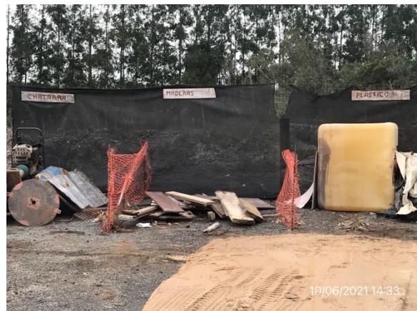
Ilustración 19 – P04, Obrador. Sector de segregación de residuos por corriente de generación.
