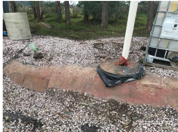
Ilustración 17 – P04, Obrador. Depósito impermeable para aguas servidas.
