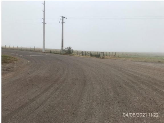
Ilustración 4 – P01, Inicio del tramo. Ruta 4, progresiva 256K700, intersección con Cno. El Tala.
