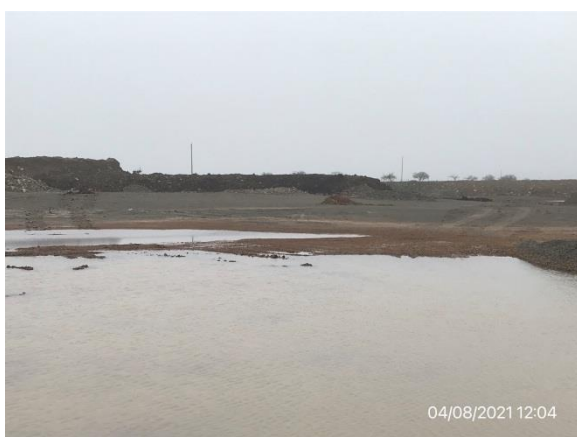
Ilustración 14 – P04, Cantera. Tareas de recuperación ambiental en curso, con suavizado de taludes en ejecución.
