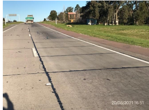
Ilustración 5 – Obras obligatorias de mantenimiento culminadas en Ruta 1, sustitución de losas de hormigón.
