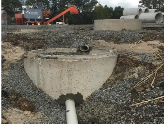
Ilustración 10 – P04, Obrador principal. Trampa de grasas en envallado perimetral de lavadero de camiones, cerrando perforación del envallado perimetral.
