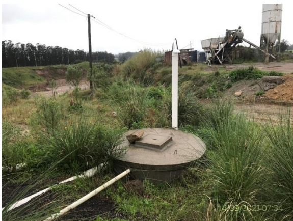
Ilustración 8 – P04, Obrador principal. Depósito impermeable para aguas servidas.
