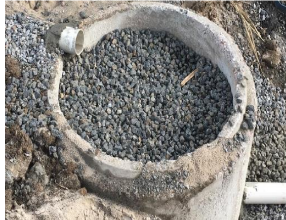
Ilustración 11 – P04, Obrador principal. Trampa de grasas en envallado perimetral de lavadero de camiones.
