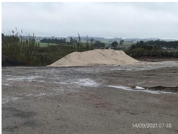
Ilustración 12 – P04, Cantera de tosca. Explanada para acopios regularizada en sector de cantera con plantación de especies nativas en talud.
