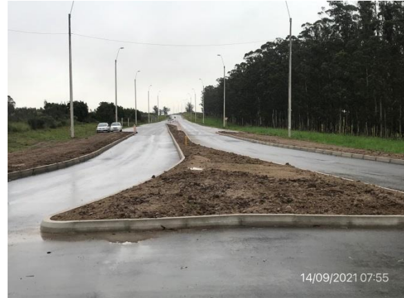
Ilustración 5 – P01, Empalme con acceso a relleno sanitario Intendencia de Rocha. No hay tapiz vegetal sobre material inerte de relleno de cantera.
