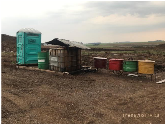
Ilustración 16 – P09, Cantera de basalto. Estación de acopio de residuos segregados y servicios de bienestar.
