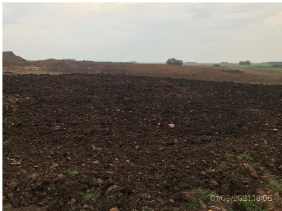
Ilustración 18 – P09, Cantera de basalto. Tendido de taludes y relleno de zona explotada parcialmente ejecutada.
