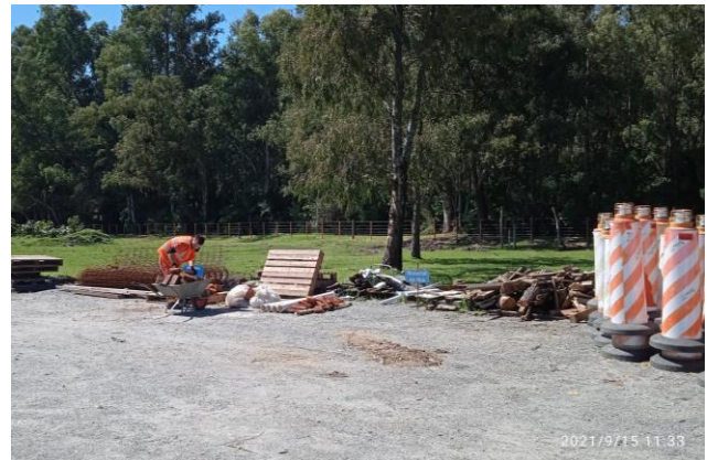
Ilustración 11 – P03, Obrador secundario. Zona de acopio de material a utilizar en obra.
