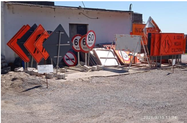
Ilustración 10 – P04, Obrador secundario. Zona de acopio de material para señalización de obra.
