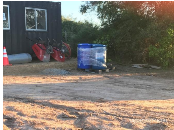
Ilustración 11 – P05, Obrador secundario. Tarrinas de productos químicos a cielo abierto, sin protección.
