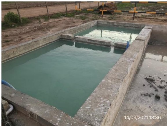
Ilustración 16 – P04, Obrador principal. Pileta de decantación para aguas de lavado de camiones mixer de hormigón.
