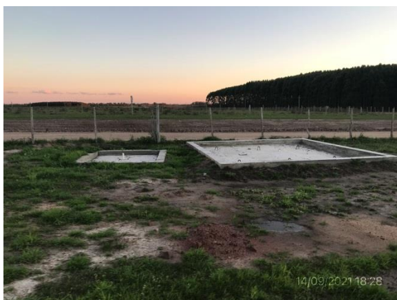
Ilustración 20 – P04, Obrador principal. Depósito impermeable para aguas servidas.
