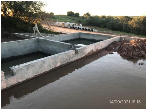
Ilustración 12 – P05, Obrador secundario. Pileta disfuncional de sedimentación de aguas de lavado de camiones mixer.
