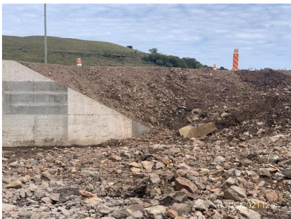
Ilustración 6 – P01, Talud al norte de alcantarilla H en senda a (+) sin restitución de tapiz vegetal.
