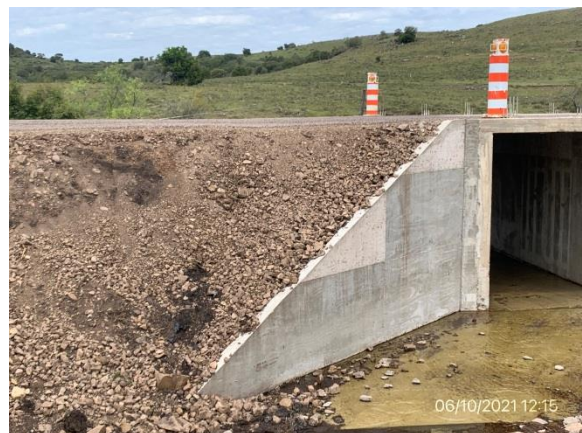
Ilustración 7 – P01, Talud al sur de alcantarilla H en senda a (+) sin restitución de tapiz vegetal.
