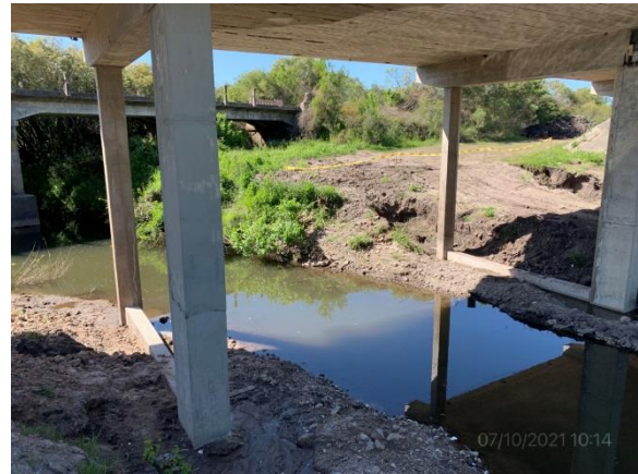
Ilustración 11 – P02, Puente sobre A° San Francisco Chico. Trabajos de recreo de pilares
