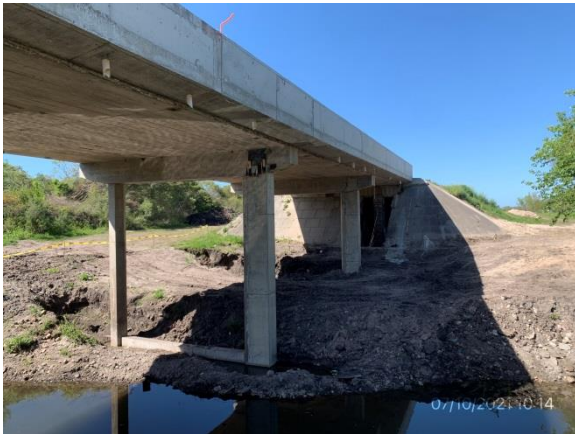
Ilustración 12 – P02, Puente sobre A° San Francisco Chico. No hay infraestructura para gestión segregada de residuos.
