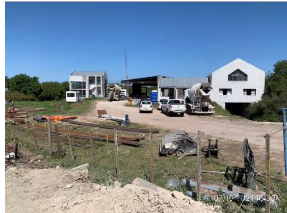
Ilustración 13 – P05, Obrador subcontratista Ingeniería Pacífico SA. Vista general. No hay separación clara que distinga obrador de emprendimiento privado.
