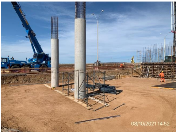
Ilustración 8 – P07 – Puente de intercambiador en obra, pilares construidos. No hay infraestructura para gestión de residuos.
