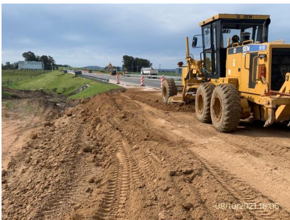
Ilustración 28 – P08. Inicio de rama Sur de intercambiador Cno. Los Arrayanes, invade zona de amortiguación de cañada.
