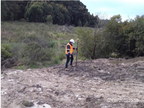
Ilustración 24 – P01. Zona de amortiguación de cañada utilizada para acopio de material de excavación en zona, Material retirado, sin protección vegetal
