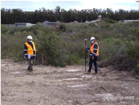
Ilustración 26 – P03. Zona de amortiguación de cañada utilizada para acopio de material de excavación en zona, Material retirado, sin protección vegetal
