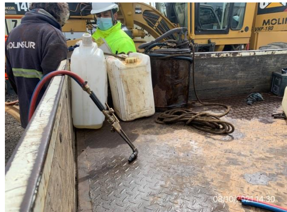
Ilustración 15 – P05, Campamento provisorio Molinsur SA. Cambio de apoyo a maquinaria, no dispone de bandejas metálicas para trabajos con hidrocarburos.
