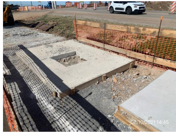
Ilustración 21 – P06, Obrador provisorio SACEEM. Pileta de lavado de camiones mixer.
