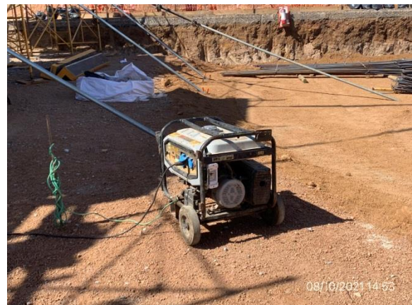
Ilustración 9 – P07 – Puente de intercambiador en obra. Grupo eléctrico sin contención para derrames..
