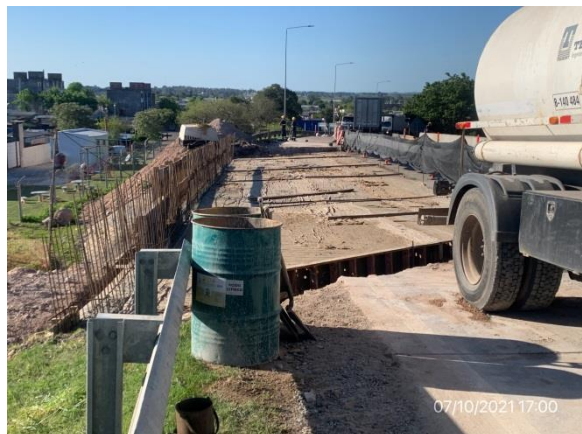
Ilustración 9 – P04, Pasaje superior sobre vía férrea. Terraplenes de ensanche de puente construidos
