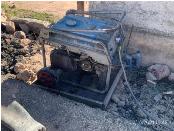
Ilustración 6 – P05, Pasaje superior sobre calle. Grupo electrógeno en funcionamiento con contención de prevención de derrames sin impermeabilizar.
