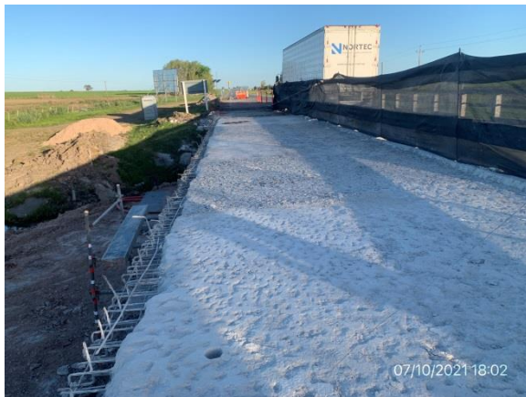
Ilustración 16 – P01, Puente sobre A° La Lancha. Obras de demolición de tablero en proceso
