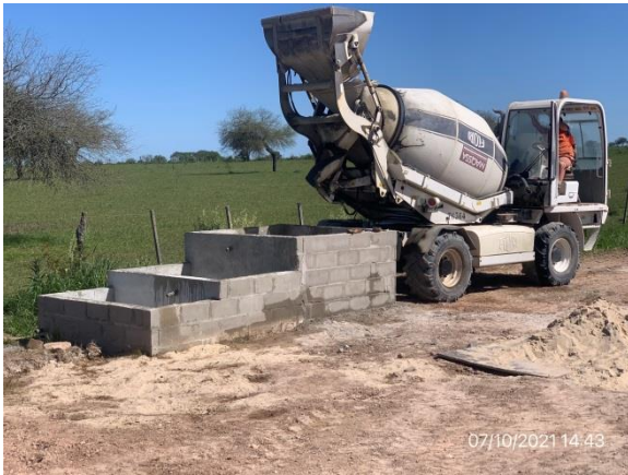
Ilustración 16 – P02, obrador principal. Pileta para aguas de lavado de camiones míxer,
