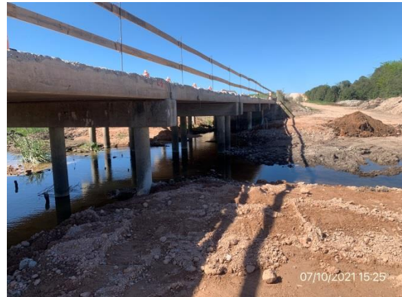
Ilustración 11 – P01, puente sobre A° Totoral. No hay un campamento provisorio con las infraestructuras requeridas por el MAV de 1998. No están indicadas las zonas de máxima creciente.
