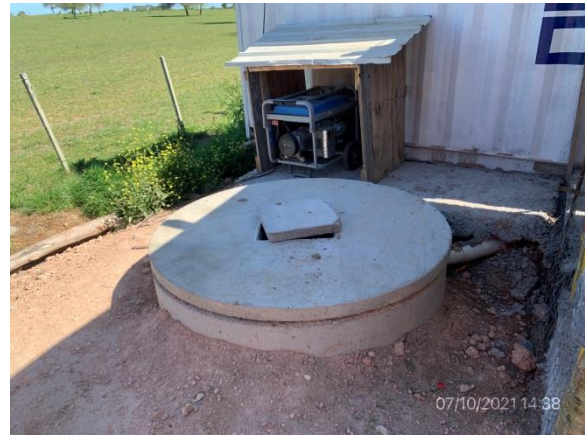
Ilustración 17 – P02, obrador principal. Depósito impermeable para aguas servidas
