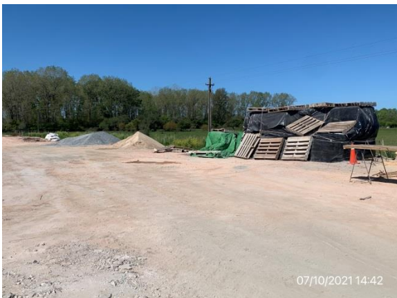
Ilustración 12 – P02, obrador principal. Explanada de maniobras y zona de acopio de áridos
