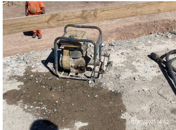
Ilustración 7 – P02, puente sobre A° Abrojal. Grupo electrógeno sin elementos de contención anti derrames.
