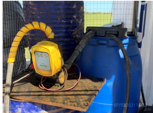
Ilustración 19 – P02, obrador principal. Depósito de combustible con envallado perimetral impermeable
