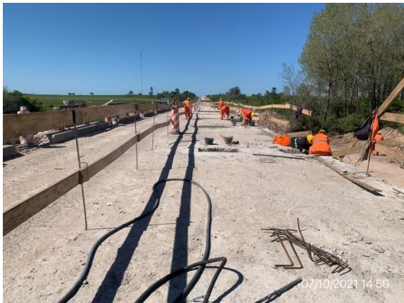
Ilustración 6 – P02, puente sobre A° Abrojal. Trabajos en mitad de tablero con tránsito abierto en media calzada.
