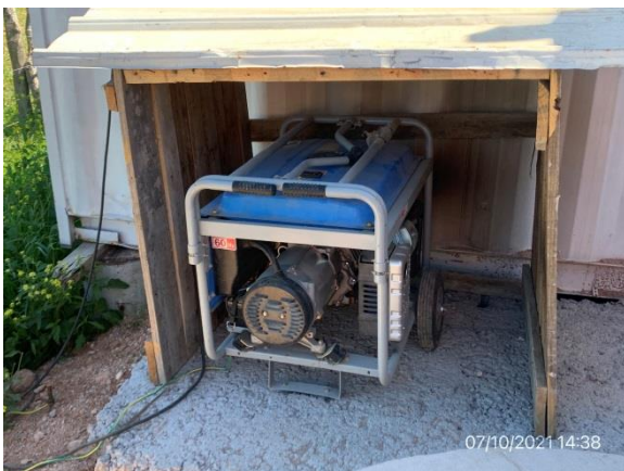
Ilustración 20 – P02, obrador principal. Grupo electrógeno en funcionamiento sin estructura de contención de derrames de combustible
