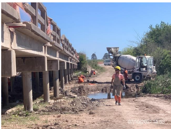
Ilustración 8 – P02, puente sobre A° Abrojal. No hay infraestructura para gestión de residuos de forma segregada.
