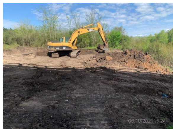
Ilustración 15 – P01, Puente sobre en Río Tacuarembó Chico. Ruta 5 progresiva 390K170. Trabajos de limpieza, en zona que no cuenta con servicios de bienestar para operarios ni sectores de acopio de residuos.
