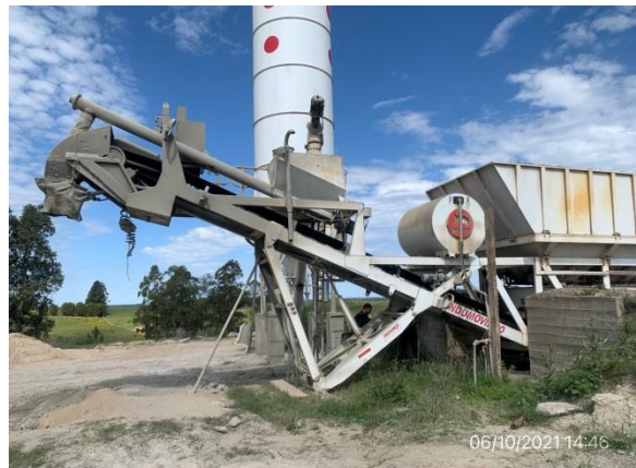
Ilustración 9 – P04, Obrador subcontratista Olecor SA Planta de hormigón.
