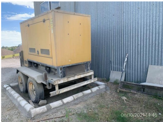
Ilustración 8 – P04, Obrador subcontratista Olecor SA. Grupo eléctrico con envallado perimetral.
