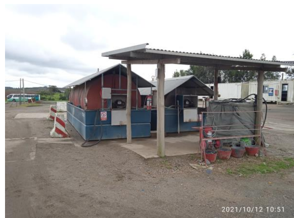
Ilustración 9 – P05, Obrador. Extintores y kit para contención de derrames.
