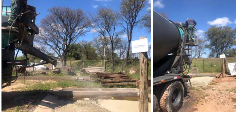
Figura 6-4 Pileta de lavado de mixer.
