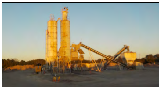
Planta de hormigón instalada en campamento de Nueva Palmira.
