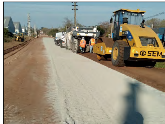
Inicio de estabilización in sitio de base de calzada en calle Ordoñana (junio '21)..
