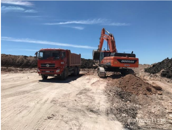
Ilustración 22 – P03, Cantera de balasto. Ruta 20 progresiva 20K000 a (+). Tareas de extracción en ejecución.
