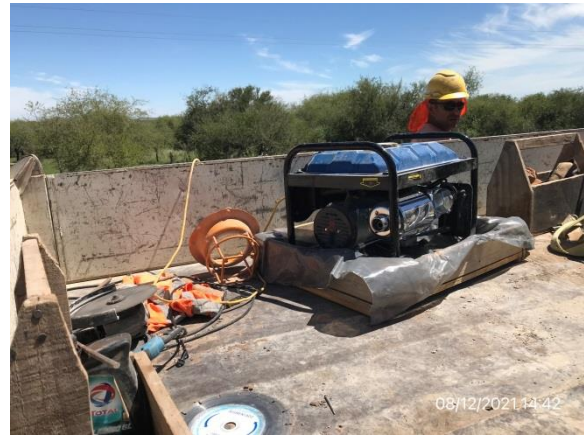
Ilustración 11 - P04, Fronte de obra. Ruta 20 progresiva 29K800. Generador eléctrico con estructura correcta de contención de derrames.
