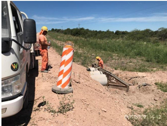
Ilustración 10 – P04, Fronte de obra. Ruta 20 progresiva 29K800. Trabajos de ejecución de alcantarillas en ejecución, subcontratista Wajery SA.
