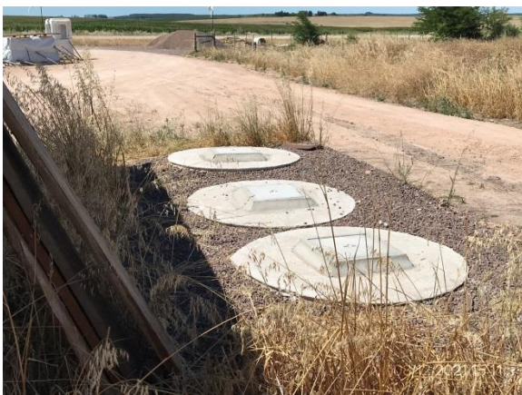
Ilustración 20 – P06, Obrador principal. Depósito impermeable para aguas servidas.
