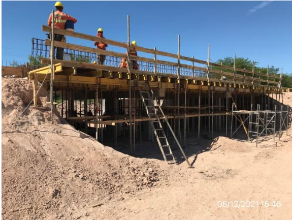
Ilustración 4 – P01, Puente sobre C da del Sauce. Trabajos en tablero superior en ejecución.
