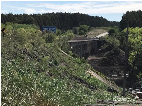
Ilustración 12 – P02, Puente sobre A° Don Esteban. No hay delimitación de área inundable.
