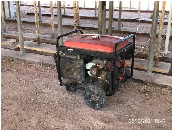
Ilustración 6 – P01, Puente sobre C da del Sauce. Generador a nafta sin bandejas para contención de derrames
