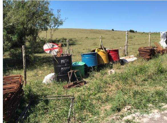
Ilustración 11 - P02, Campamento provisorio en puente sobre A° Don Esteban. Estación de segregación de residuos correcta. No hay servicios de confort para operarios.
