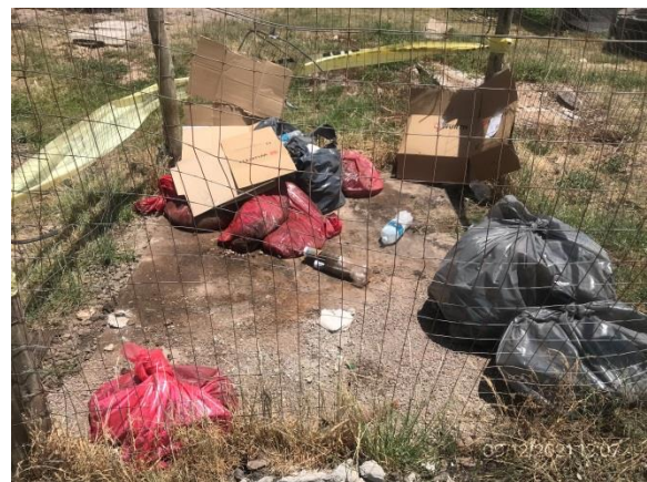
Ilustración 7 – P03, Obrador principal. Sector de acopio de residuos en malas condiciones.
