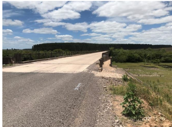
Ilustración 19 – P02, fin del tramo. Cabecera Norte de puente de Ruta 59 sobre el A° Malo.
