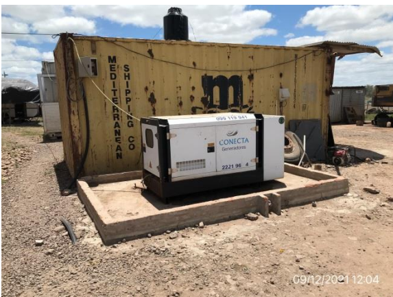
Ilustración 8 – P03, Obrador principal. Grupo electrógeno con envallado perimetral.
