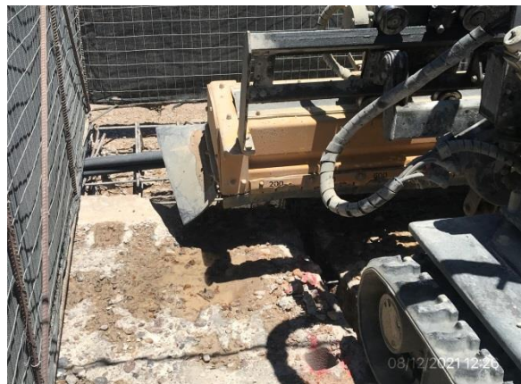
Ilustración 9 – Puente de Ruta 2 sobre el río Negro, campamento superior. Equipo de hidrodemolición.
