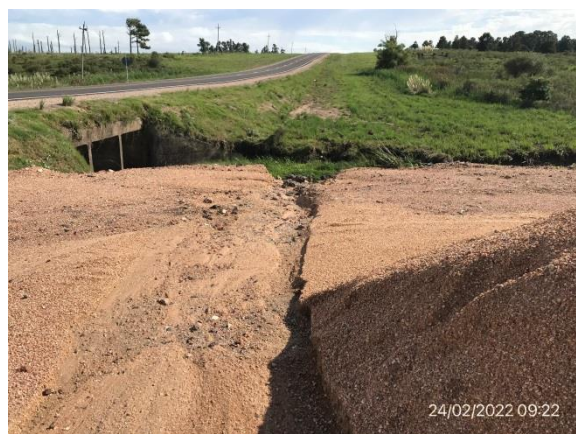
Ilustración 7 – P03, Acopio provisorio de materiales granulares. Evidencia de arrastres de material hacia curso de agua.
