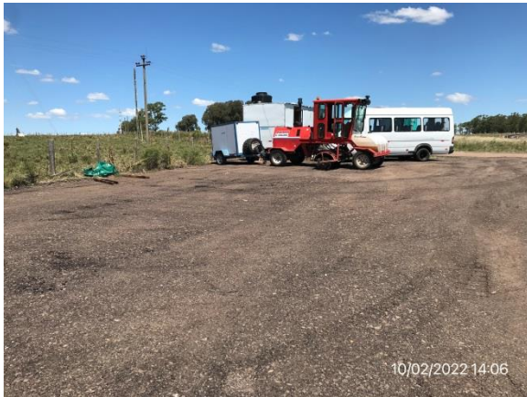
Ilustración 10 – P04, Frente de obra. Ruta 5 progresiva 294K000. Campamento móvil, explanada para estacionamiento de maquinaria
