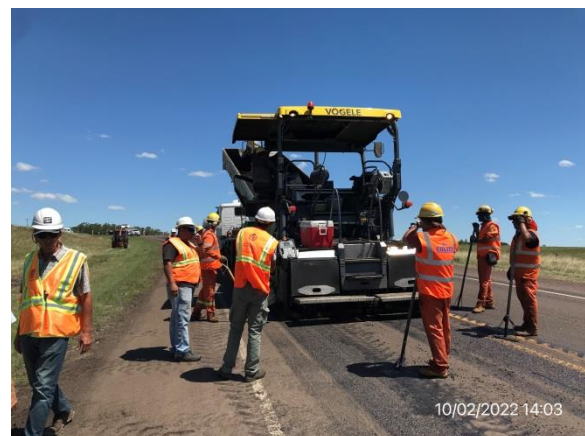
Ilustración 9 – P04, Frente de obra. Ruta 5 progresiva 294K000. Tareas de recapado en ejecución.
