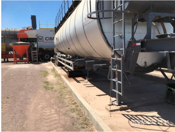
Ilustración 22 – P03. Planta asfáltica. Depósitos de emulsiones y caldera con envallado perimetral.
