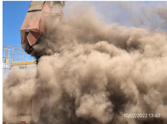
Ilustración 25 – P03. Planta asfáltica. Importantes emisiones de material particulado, con varias reiteraciones observadas a pie del equipo.
