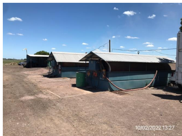
Ilustración 15 – P03. Obrador. Depósitos de Gas Oil techados con envallados perimetrales.
