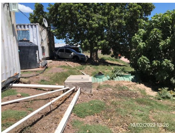
Ilustración 14 – P03. Obrador. P03. Obrador. Fosa séptica.
