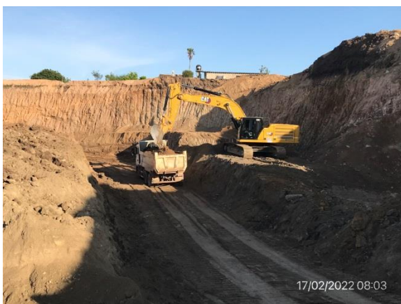
Ilustración 14 – P04, Cantera de tosca. Ruta 6, progresiva 208K200 a (-). Maquinaria trabajando, no hay instalaciones básicas para manejo de hidrocarburos según AAO de la cantera.
