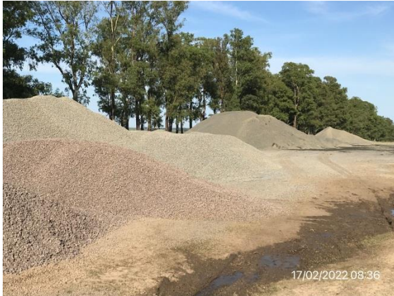
Ilustración 16 – P05, Cantera y campamento provisorio. Ruta 6, progresiva 222K800 a (-). Acopios de material triturado.
