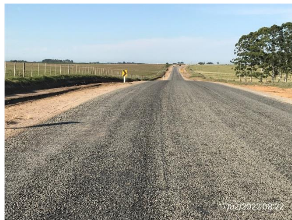
Ilustración 5 – Tramo de Ruta 6 con obras terminadas, base recargada y tratamiento bituminoso ejecutado.
