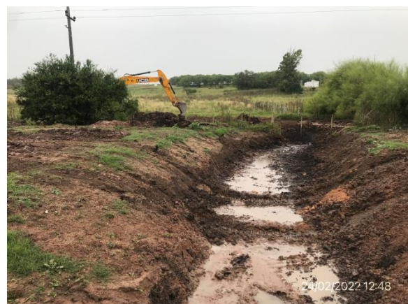
Ilustración 15 – Tramo en obra, Ruta 81. Tareas de limpieza y regularización para construcción de alcantarillas.
