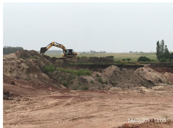
Ilustración 9 – P05, Cantera de limo. Ruta 81, progresiva 49K800 a (+). Maquinaria en operación. No hay servicios de confort para operarios ni infraestructura para gestión de residuos y atención de contingencias.
