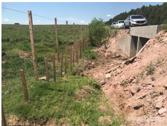
Ilustración 6 – P03, Nueva alcantarilla. Cno. a la Balsa progresiva 16K000. Taludes erosionados por fuerte pendiente y falta de protección.
