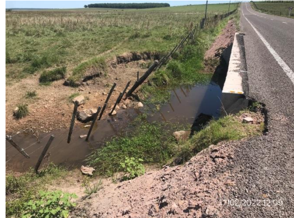
Ilustración 11 – P05, Nueva alcantarilla. Cno. a la Balsa progresiva 14K300. Obstrucciones por arrastres y desprendimiento de material granular.
