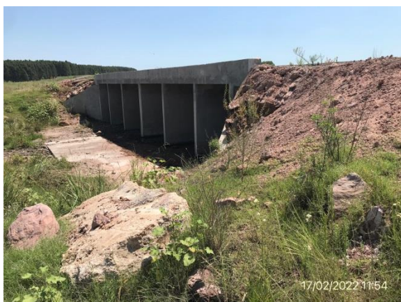
Ilustración 8 – P04, Nueva alcantarilla. Cno. a la Balsa progresiva 18K700. Taludes erosionados por fuerte pendiente y falta de protección.
