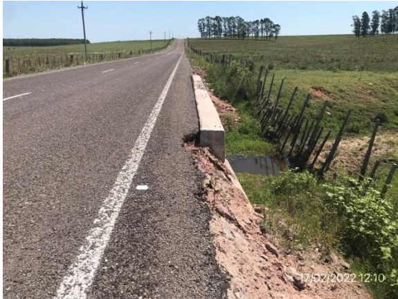
Ilustración 10 – P05, Nueva alcantarilla. Cno. a la Balsa progresiva 14K300. Taludes erosionados por fuerte pendiente y falta de protección.
