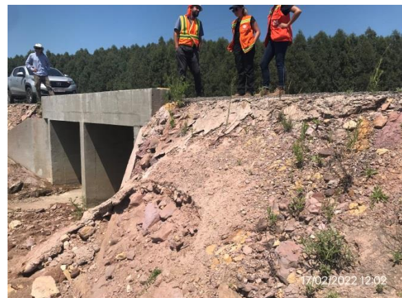
Ilustración 7 – P03, Nueva alcantarilla. Cno. a la Balsa progresiva 16K000. Obstrucciones por arrastres y desprendimiento de material granular.
