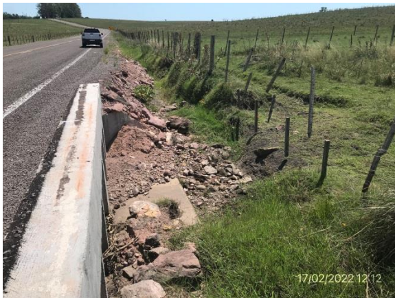
Ilustración 12 – P06. Nueva alcantarilla. Cno. a la Balsa progresiva 13K250. Taludes erosionados por fuerte pendiente y falta de protección.
