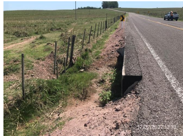
Ilustración 13 – P06. Nueva alcantarilla. Cno. a la Balsa progresiva 13K250. Obstrucciones por arrastres y desprendimiento de material granular.
