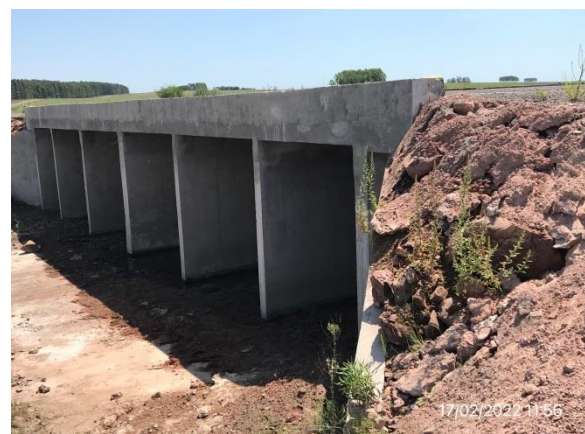
Ilustración 9 – P04, Nueva alcantarilla. Cno. a la Balsa progresiva 18K700. Obstrucciones por arrastres y desprendimiento de material granular.
